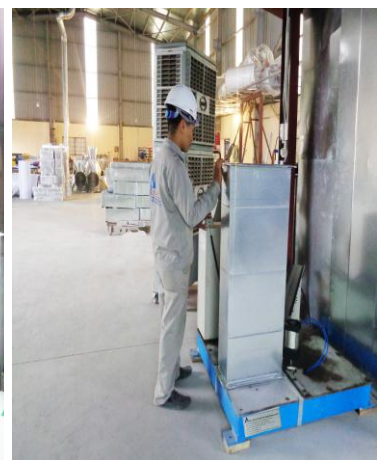
Máy vào ke ống gió
